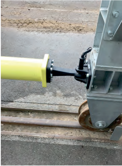
Afb. 2 Een verbindingsstuk koppelt de stortbunker aan de loskraan
